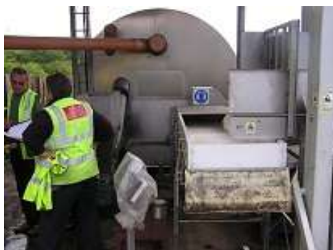
Trémie d'alimentation + fermenteur - - Restauration parc d'attraction Eden project au Royaume Uni (1200 repas/jour)
